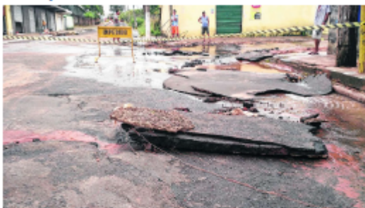
Parte do asfalto cedeu no Jardim Vienense e a rua precisou ficar interditada pela prefeitura
